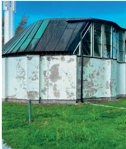
Schäden an der Putzfassade 2022
